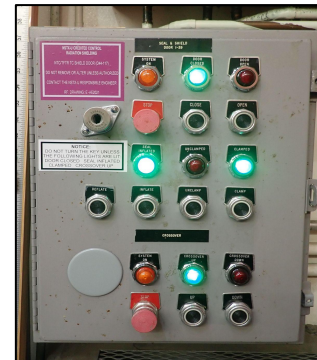
TFTR Shield Door Control Panel
