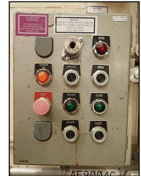
NB Shield Door Control Panel
